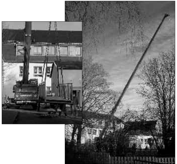
Montage des zweiten Rettungsweges in der Kita „Zwergenland“ Oberlichtenau. (KP II Maßnahme)
